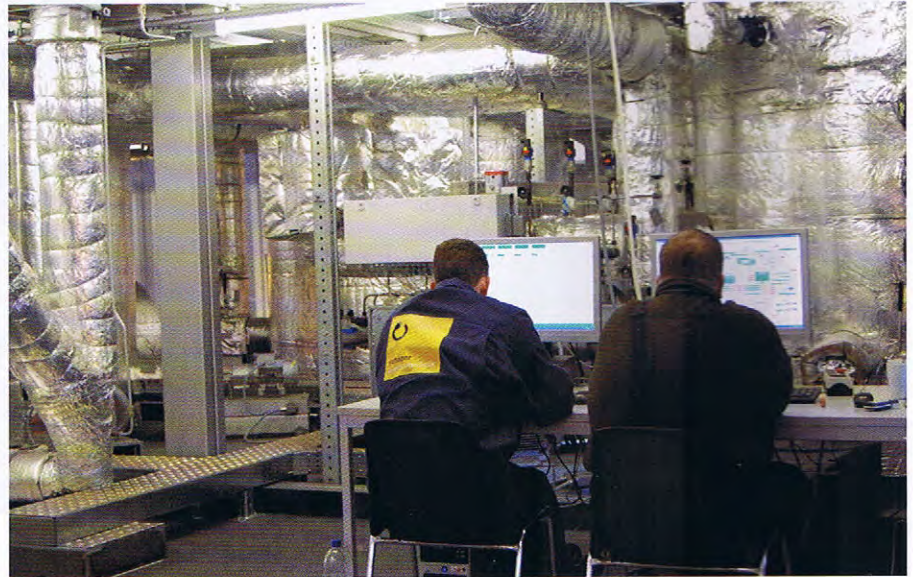
Über eine komfortable Visualisierung ist es möglich, die Anlagentechnik zu bedienen, Betriebszustände anzuzeigen und zu speichern.
